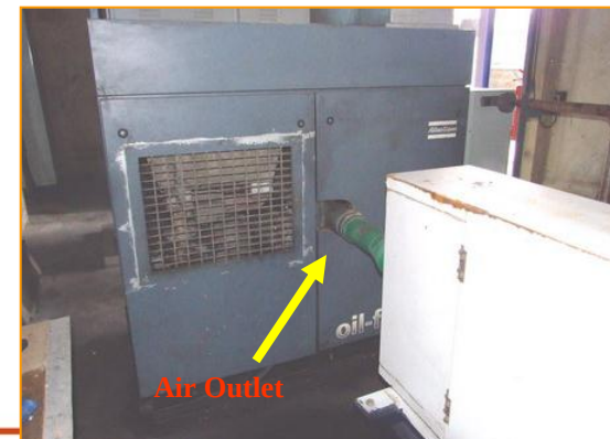
ภาพแสดงการต่อเข้าระหว่าง Chemical filter กับ Air compressor
