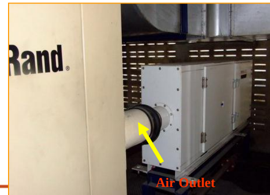
ภาพแสดงการต่อเข้าระหว่าง Chemical filter กับ Air compressor
